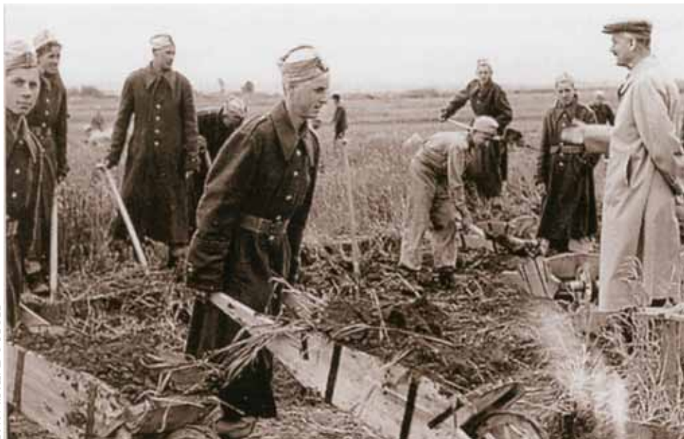
Preofesor Anioła podczas prace przy wykopie pod fundamenty pierwszego wielkiego pieca – 16 maja 1952 roku
