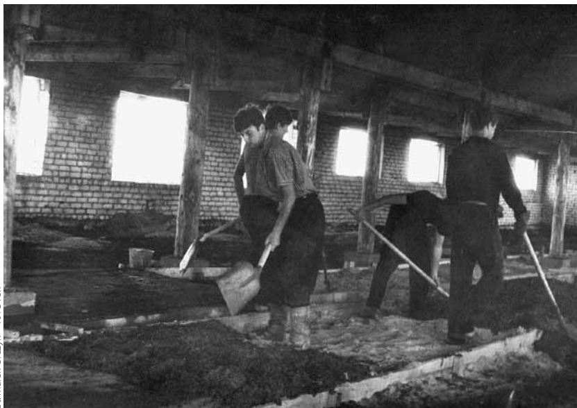
Praktyka studencka w ZSRR (obecna Rosja) sowchoz AMO – betonowanie wybiegów dla świi
